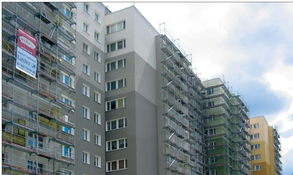
Znakomitym przykładem optymalnego wykorzystania rusztowania ramowego BLITZ jest inwestycja zrealizowana przez firmę Jack- Bud
